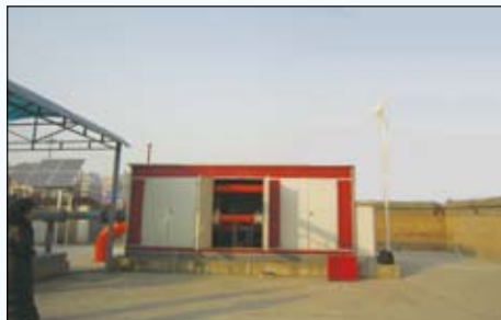
图6 马坊东路次高压箱风光互补发电系统
