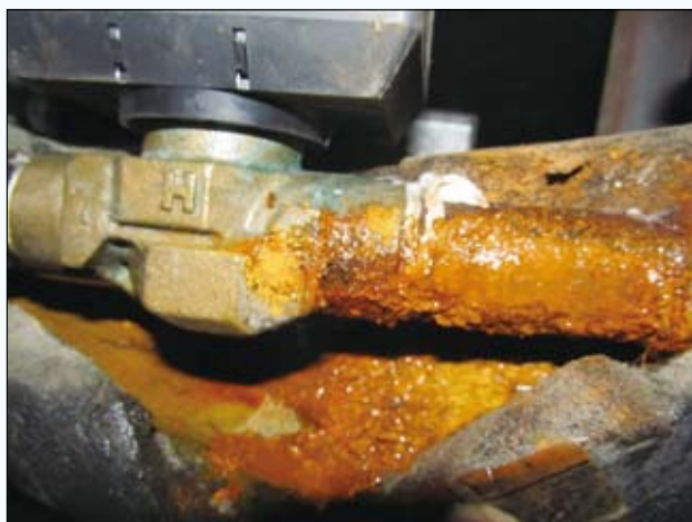
图5 电偶腐蚀：铜阀门与钢管连接时，钢管加速腐蚀
