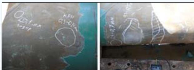
图9 管道NO.I损伤区域
