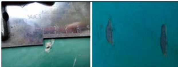
图8 管道NO.I防腐层缺陷
