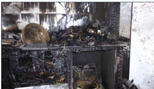
图1 某居民用户燃气爆炸事故现场
