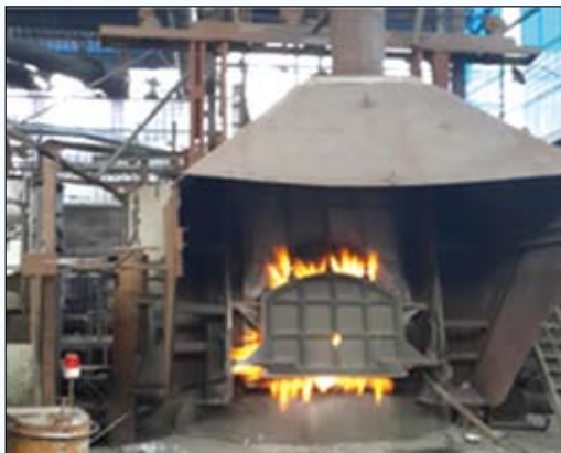
图5 炉压过高，火焰向外喷出
