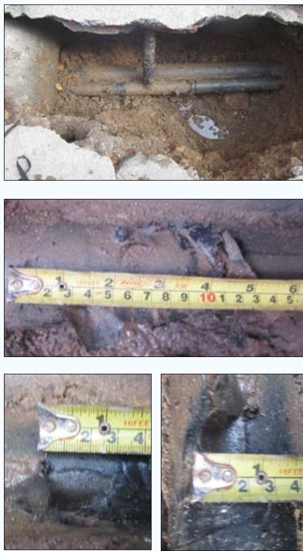
图2 破损点开挖验证图
