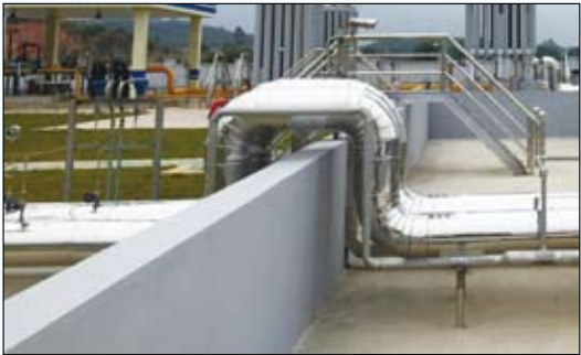
图1 气化站中翻越围堰的方形管道簇
