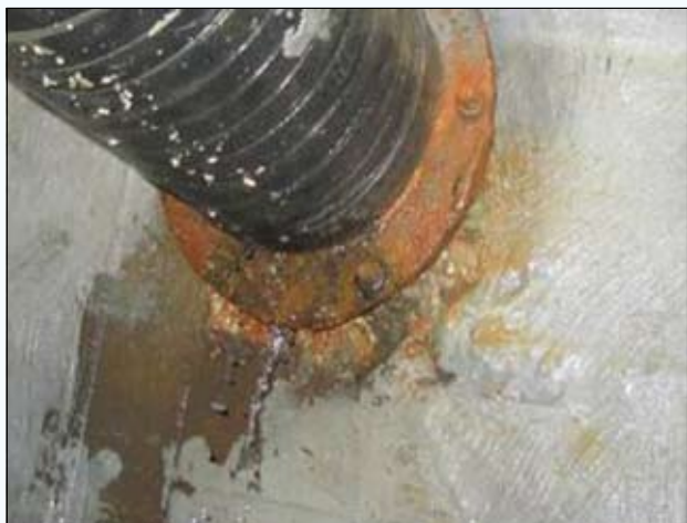
图3 井壁裂缝渗水
