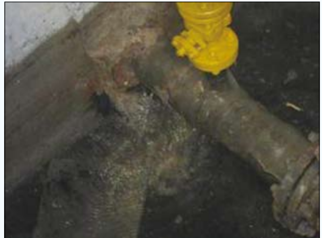
图2 柔性套管损坏流水
