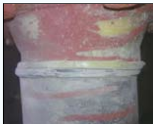
图9 聚乙烯管道焊缝错边
