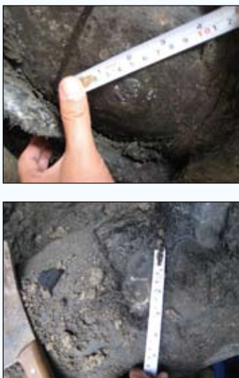
图7 燃气管道腐蚀情况
