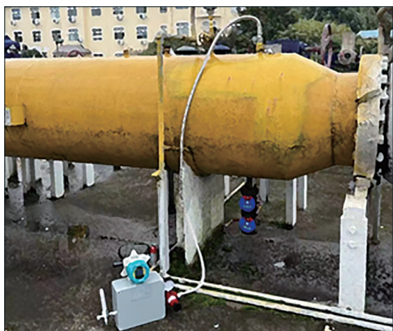
图2 在线甲烷分析仪监测管道内甲烷含量
