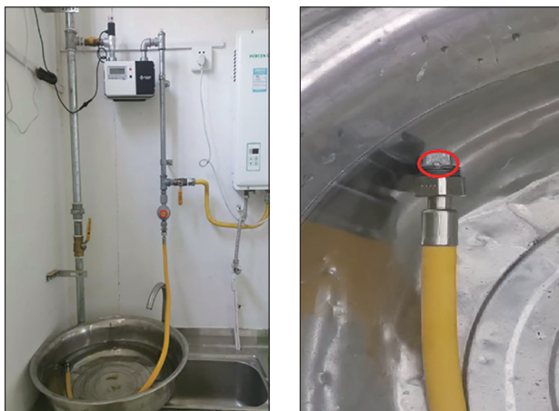
图4 水膜气泡法定量模拟燃气微小泄漏
