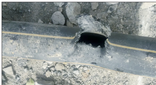
图2 第三方破坏现场实物图 [4]
