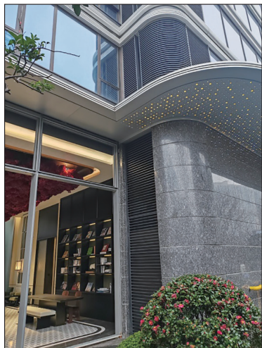
图3 燃气引入管被设备平台通风格栅遮蔽
