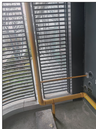
图4 设备平台通风格栅内部燃气引入管实景
