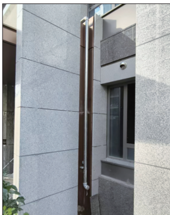
图8 外立面专用U型管内燃气引入管实景
